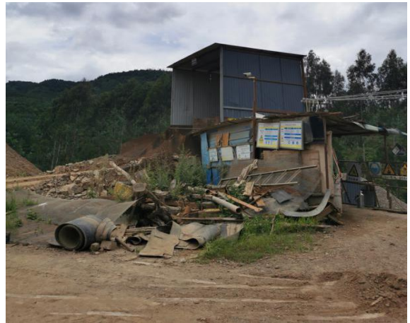
2#生产线破碎机现状（现有）
