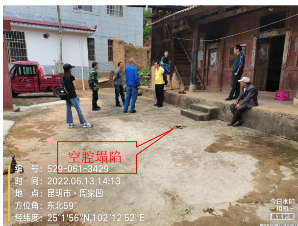
照片1 周正国村民场院空腔塌陷
