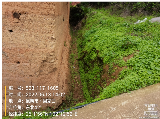
照片 5 周正国户排水沟浸潮积水
