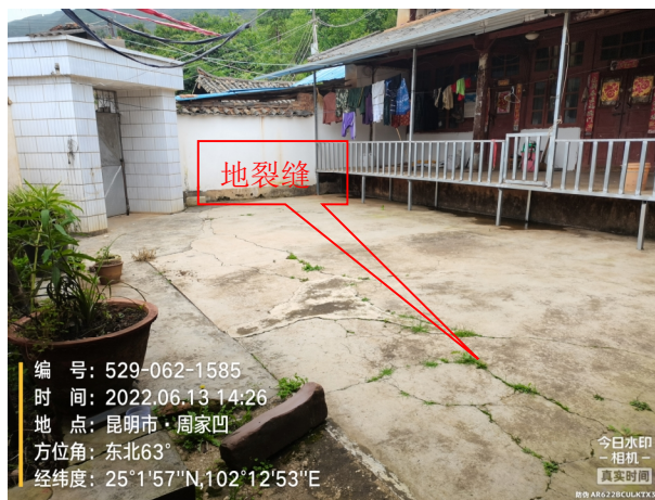
照片2 周正乔村民场院地面开裂
