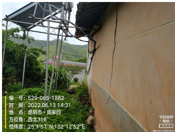
照片 4 周正乔户排水沟缺失
