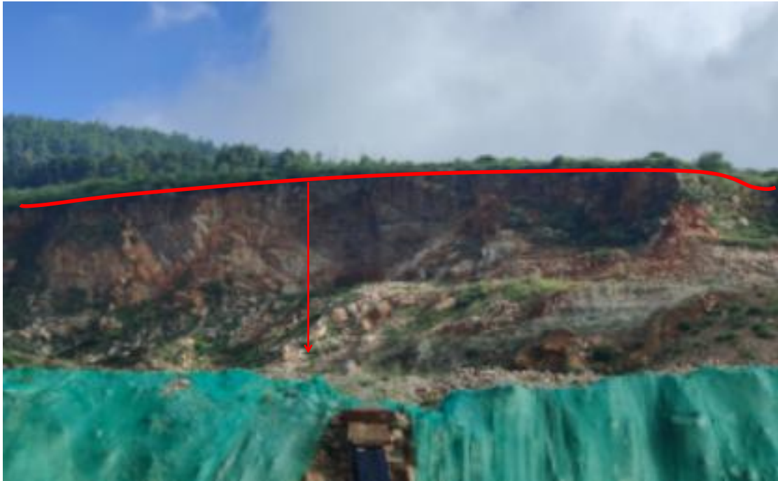
图 3-8 不稳定边坡 BW1 近景现状
