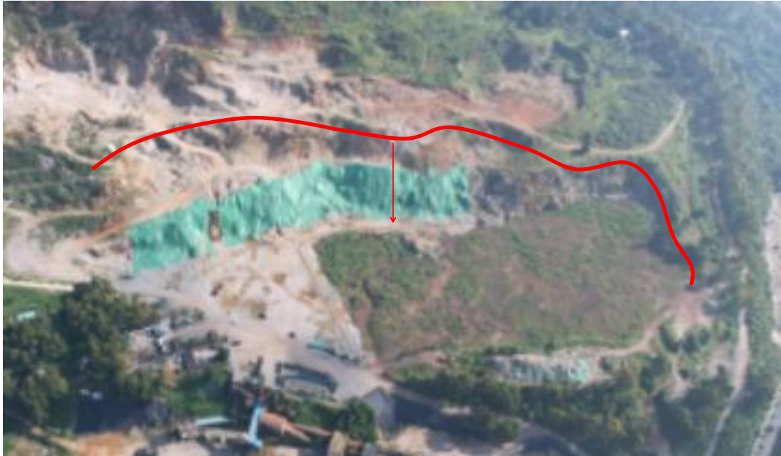
图 3-11 不稳定边坡 BW2 远景现状
