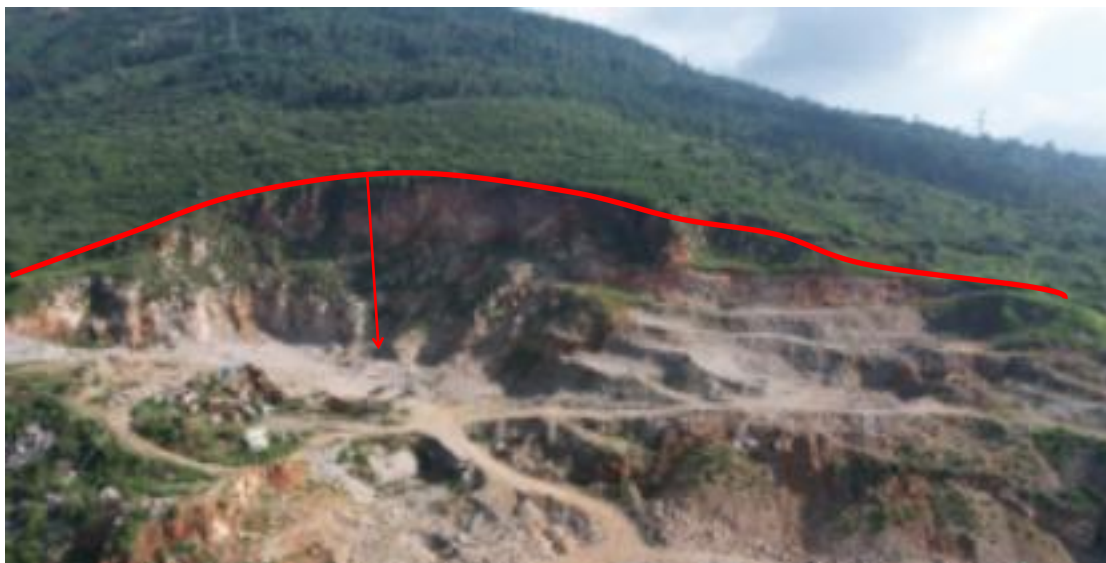
图 3-7 不稳定边坡 BW1 远景现状
