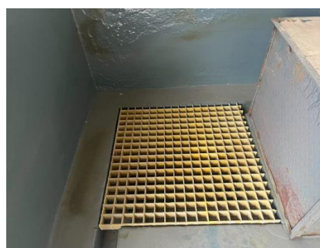
危废暂存间应急收集池
