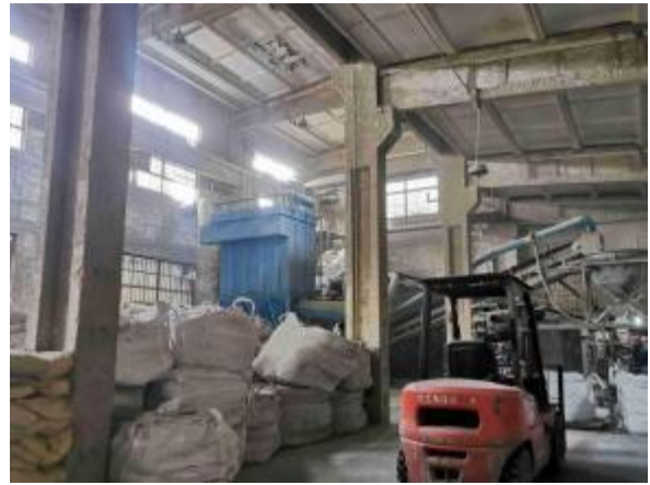
不定形耐火材料 2 线配料收尘、除尘
