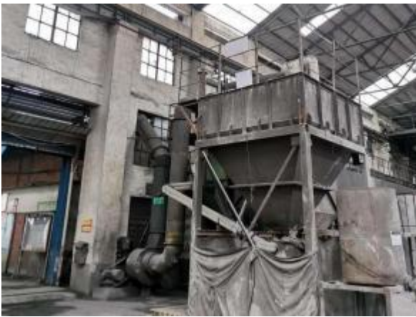
镁碳、铝镁碳砖 1 线原料破碎除尘
