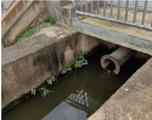
污水管线接入现有农灌沟起点（丰水期）
