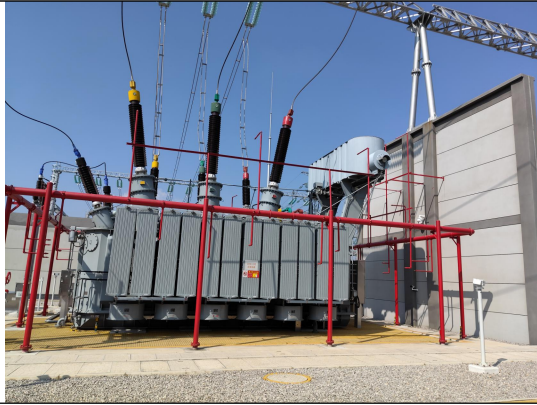
3#主变及贮油坑
