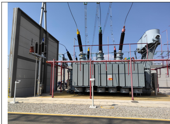
2#主变及贮油坑
