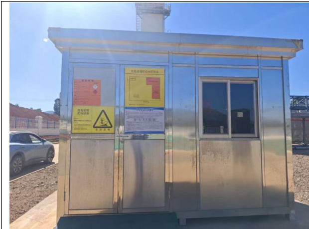
危废暂存间（现有）
