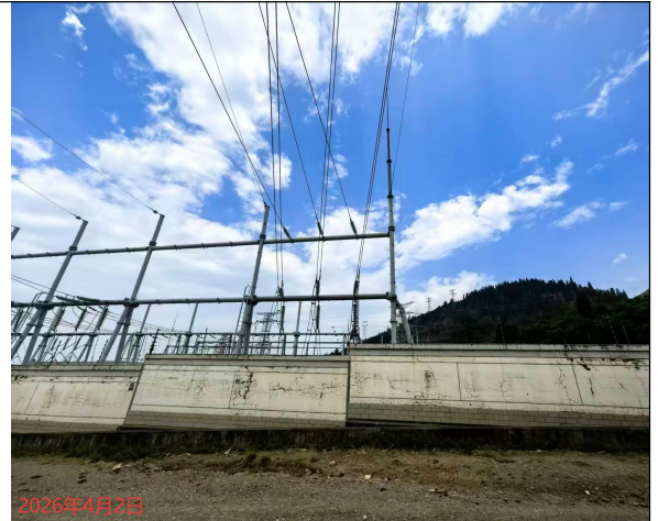
本项目线路终点——220kV 温泉变进线间隔
