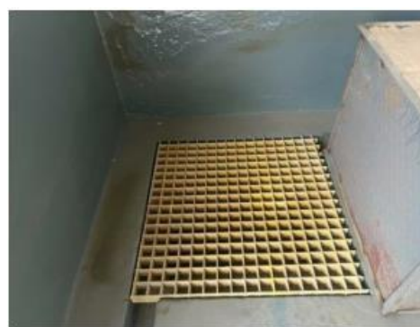
危废暂存间应急收集池
