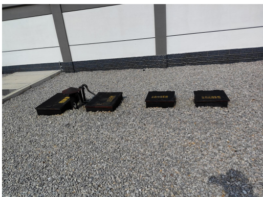
一体化污水处理设备
