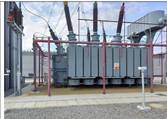
2#主变及贮油坑
