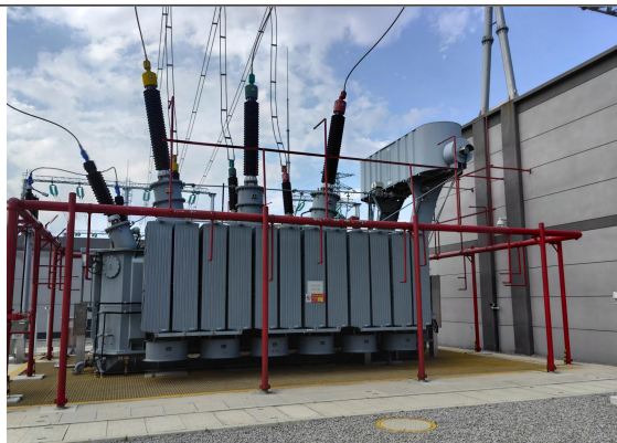
3#主变及贮油坑
