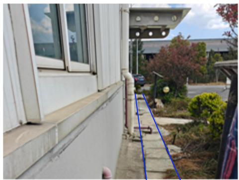
园区内雨水管道
